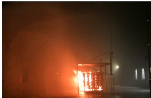
(d) 120 s after activating FFFS
