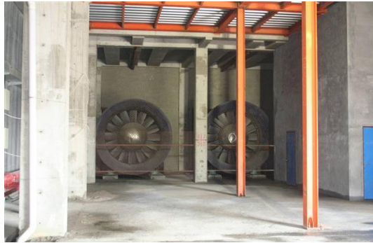
(b) Ventilation Fan
