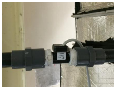
(d) Turbine flow rate sensor
