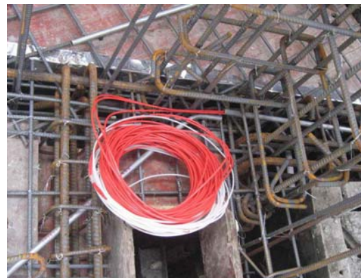
(d) Protection of cables
